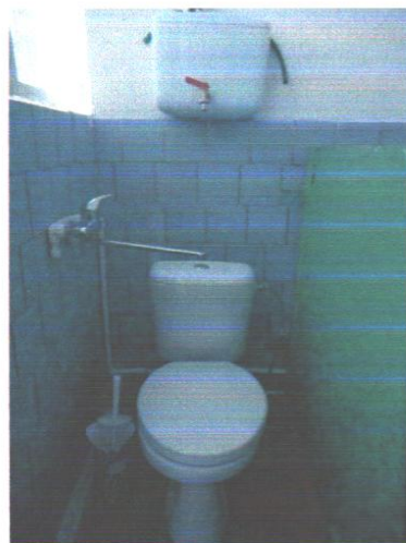
Фото №19 – Туалетная комната (унитаз)
