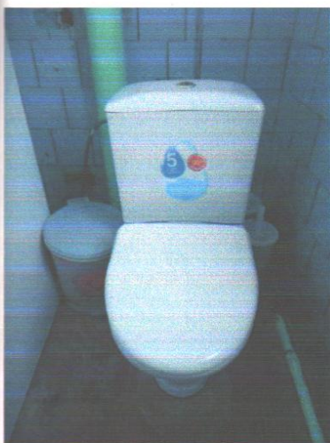
Фото №18 – Туалетная комната (унитаз)
